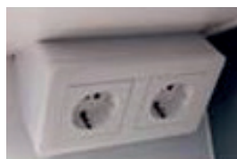
Kulmapistorasia ja led-valolista Asennettuna alumiiniprofiiliin.
