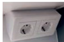
Kulmapistorasia ja led-valolista asennettuna alumiiniprofiiliin.
